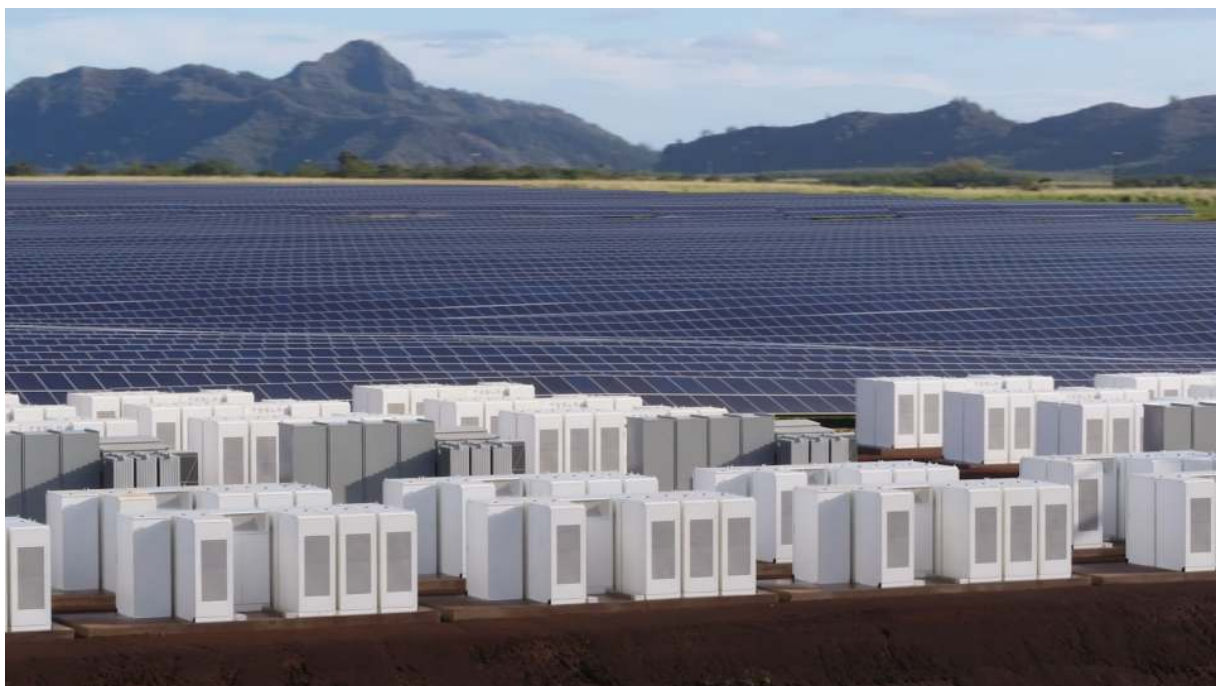
Figura 30: Instalación de Megapacks en Hawaii
