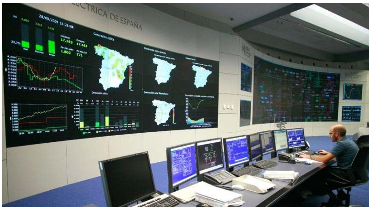
Figura 4: El Centro de Control de Red Eléctrica de España (CECOEL) en Alcobendas.
